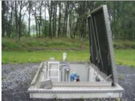
Foto 3. Putkelder (foto KWR)
